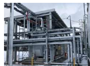
◀ ガスコージェネレーション
